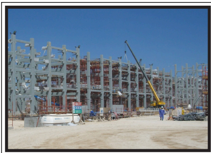
Onshore LNG Facility.
